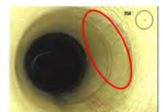
Bild 22 Feuchtigkeit ohne Infiltration
