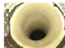
Bild 21 Dicht saniertes Schadensbild (keine Auffälligkeiten)
