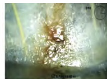
Bild 16 Feuchtigkeit und Verfärbung
